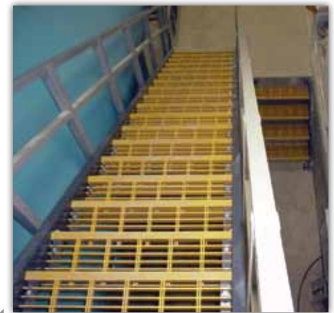
L'escalier du dessus, doté de marches moulées Fibertred, permet d'accéder au réservoir d'une station de pompage.
